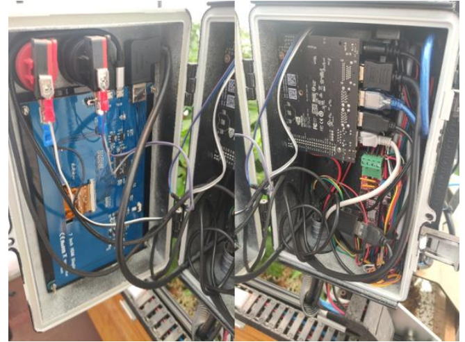
FIGURA 2. Caja de componentes del sistema electrónico de control, que incluye la Jetson nano, y la etapa de potencia.
